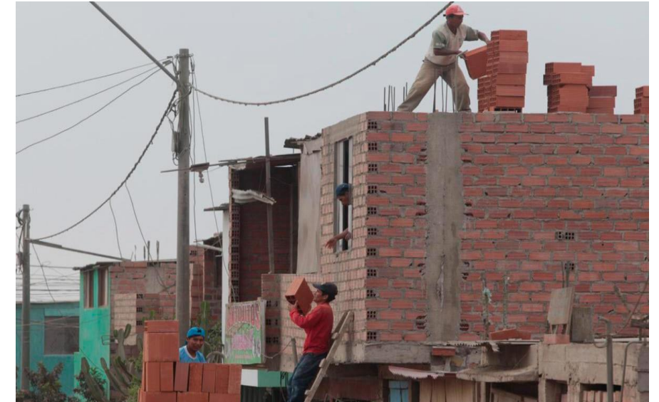
適切な構造設計がされていない組積造（レンガ積み）の建物が多い
